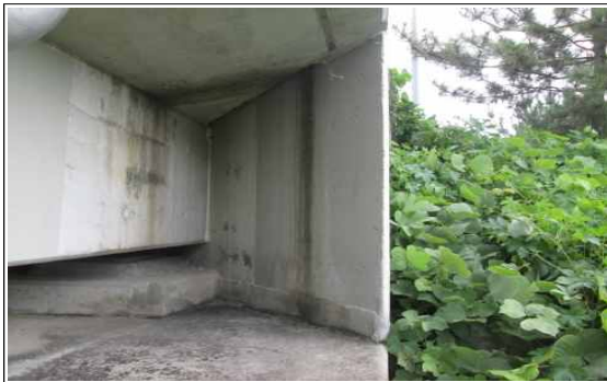
신축이음 하행선 A1 하부 누수(홍벽 누수흔적)
