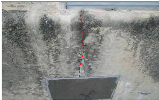
하행선 S2 방호벽 균열(폭 0.3mm)
