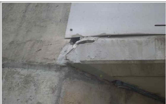
바닥판하면 하행선 S1 콘크리트 박락(보수부 재손상)
