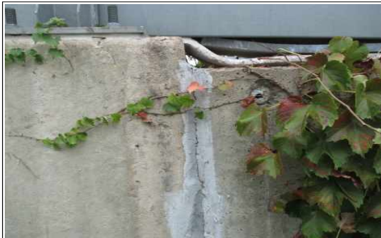
하행선 A1측 접속도로 방호벽 단차
