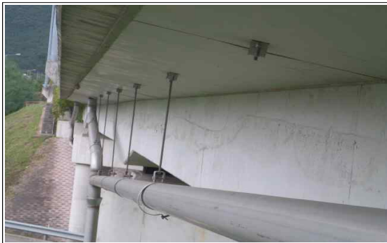
배수시설 하행선 S1 배수관 연결재 탈락
