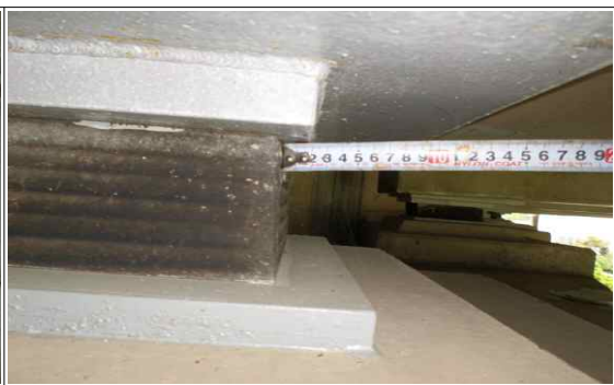
교량받침 하행선 A1 SH5 고무재 밀림
