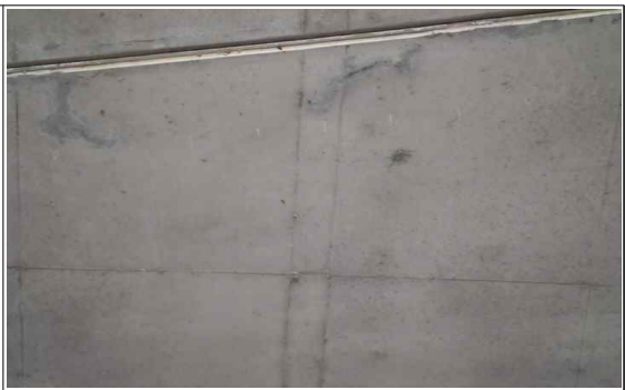
바닥판하면 상행선 S1 균열(폭 0.1~0.2mm)
