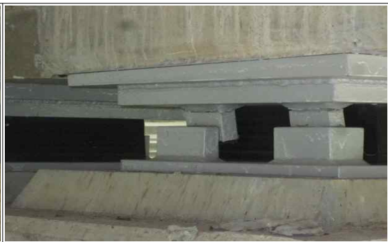
교량받침 상행선 P1 SH8 스톱퍼 파손
