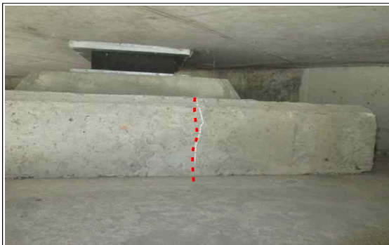
교량받침 하행선 A1 SH3 받침콘크리트 균열(폭 0.3mm)
