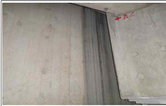
교대 하행선 A1 흉벽 누수흔적(신축이음 하부 누수)
