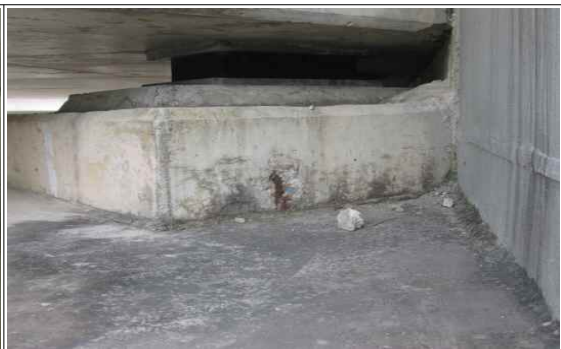
상행선 A2 SH7 받침콘크리트 손상 및 철근노출
