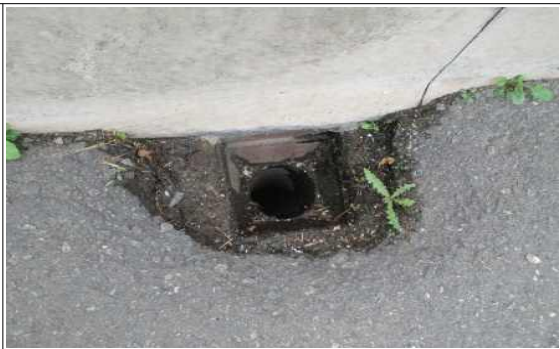
배수시설 하행선 S2 배수구 덮개 망실
