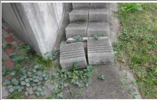
상행선 A2 점검계단 하부 손상
