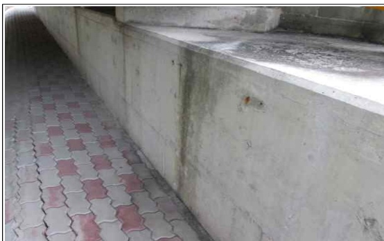
교대 하행선 A1 벽체 누수흔적
