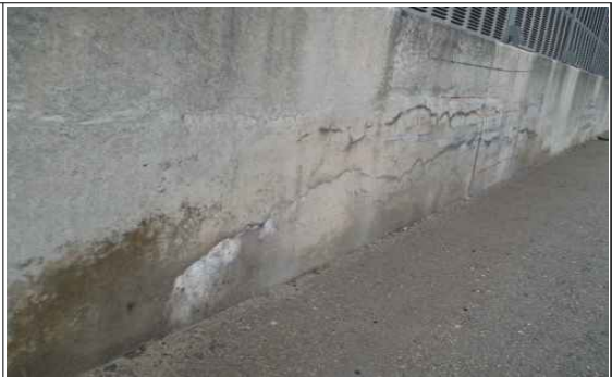
방호벽 하행선 S2 망상균열 및 백태
