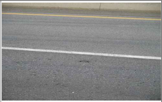
교면포장 하행선 S3 포트홀
