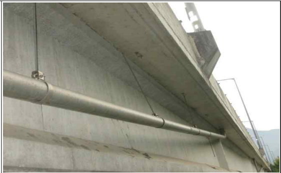
배수시설 하행선 S3 배수관 연결재 탈락
