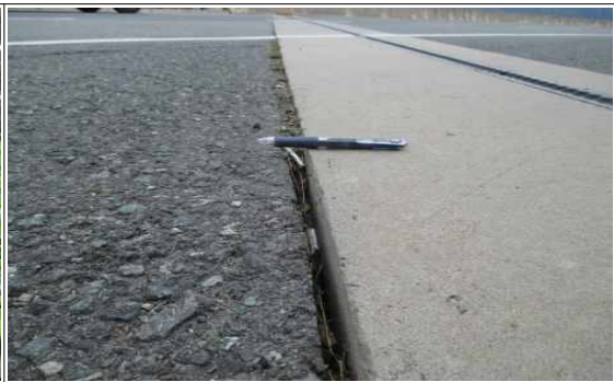
신축이음 하행선 A2 후타재 접속부 이격 및 단차
