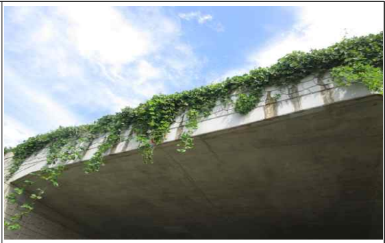
바닥판하면 하행선 S1 오염 및 균열(폭 0.2mm)
