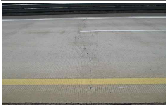
교면포장 하행선 S1 포장면 균열
