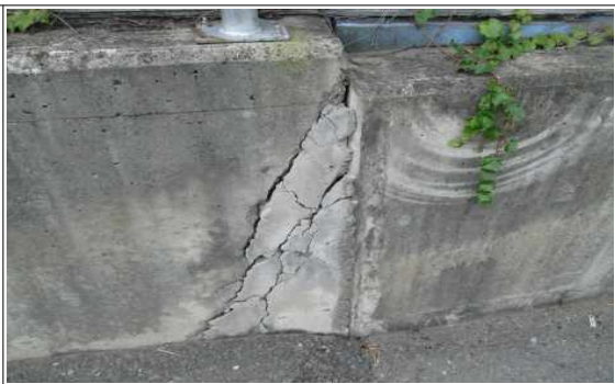
하행선 A2측 접속도로 방호벽 단차(진전없음) 및 콘크리트 박락
