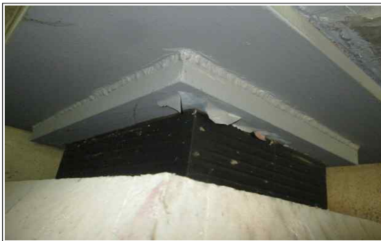
교량받침 하행선 A2 SH4 Plate 도장손상
