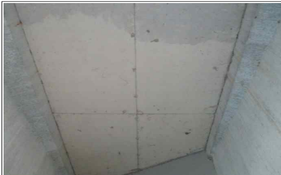
바닥판하면 상행선 S2 망상균열
