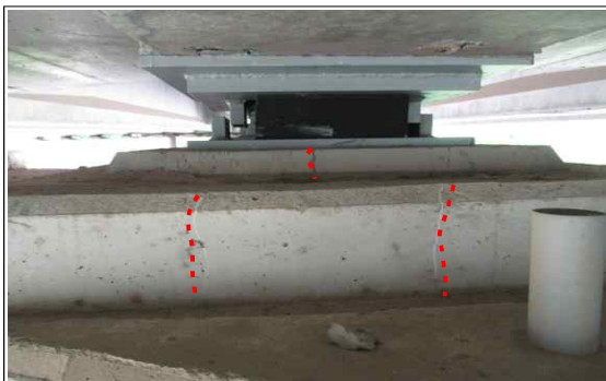
교량받침 상행선 P1 SH3 무수축물탈 및 받침콘크리트 균열
