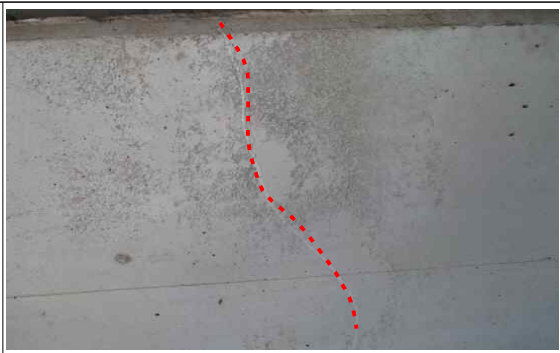
교각 하행선 P1 코핑부 정면 균열(폭 0.3mm)
