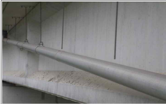
배수시설 하행선 S1 배수관 연결고리 탈락
